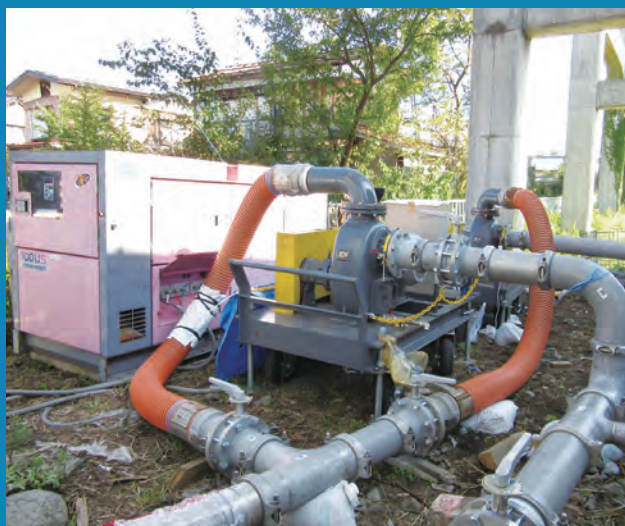
【バルブの開閉で予備ポンプへ「迅速に」切替】
